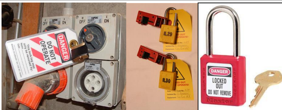
Figura 7: dispositivos de bloqueo de aislación
